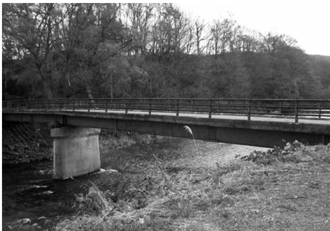
早期措置段階の区分Ⅲに分類される向山橋
